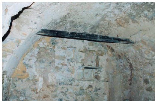
Εικόνα 6. Ενισχυτικοί ξύλινοι ελκυστήρες.
