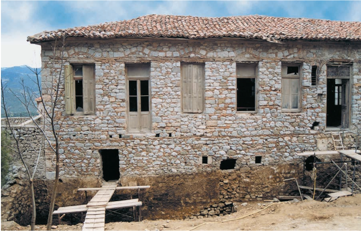
Εικόνα 5α. Άποψη της ΒΑ πτέρυγας από βορρά μετά την αφαίρεση των επιχρισμάτων –Διακρίνεται ο τρόπος δομήσεως των τοικοποιιών του τρίτου και τετάρτου ορόφου καθώς και η κατάσταση διατήρησης του μνημείου
